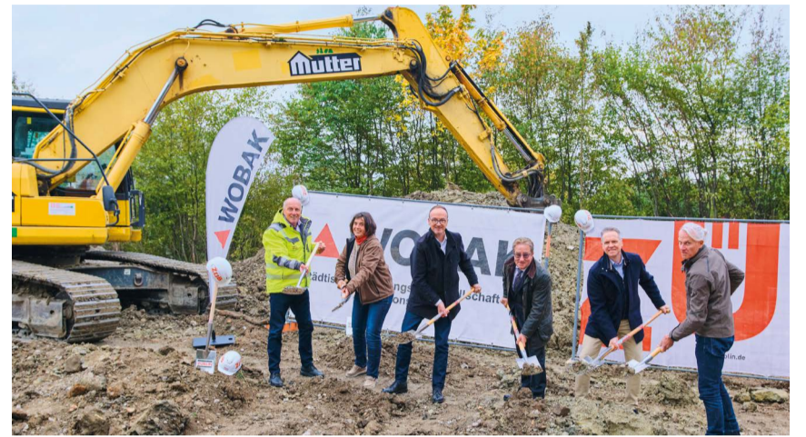
In der Leipziger Straße baut die WOBAK 16 Wohnungen für Haushalte mit besonderen Schwierigkeiten bei der Wohnraumversorgung. Von links nach rechts: Joachim Dannecker vom ausführenden Bauunternehmen Züblin, Anne Mühlhäußer (Aufsichtsrätin WOBAK), OB Uli Burchardt (Oberbürgermeister der Stadt Konstanz), Jens-Uwe Götsch (Geschäftsführer WOBAK), Michael Moser (Leiter Projektentwicklung WOBAK) und Hannes Mayer (Architekt, Projektleiter WOBAK).
