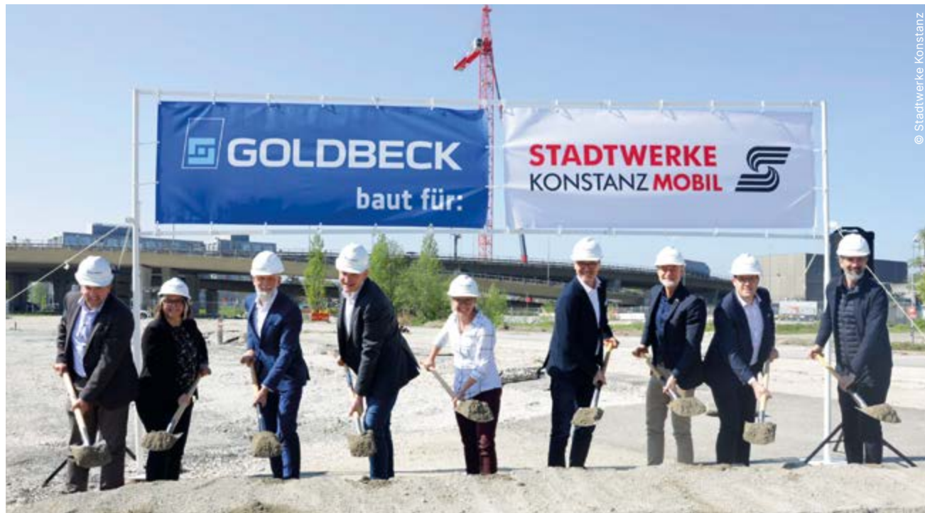
Spatenstich für das neue Parkhaus Europabrücke in Konstanz: (von links) Kai Haber (Geschäftsleitung Stadtwerke), Katja Romer (Projektleitung Stadtwerke), Dr. Norbert Reuter (Geschäftsführer Stadtwerke), Jörg Parschat (Niederlassungsleiter Firma Goldbeck Engen), Nina Welschinger (Stadtwerke Konstanz Mobil GmbH), Oberbürgermeister Uli Burchardt, Bürgermeister Karl Langensteiner-Schönborn, Andreas Müller (Verkaufingenieur Firma Goldbeck) und Architekt Roland Haehnel.
