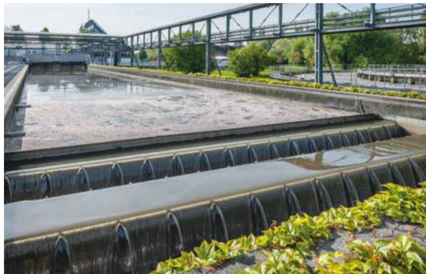
Am Abfluss der Grobentschlammung sind die sichtbaren Fremdstoffe entfernt, gereinigt ist das Abwasser noch nicht.
